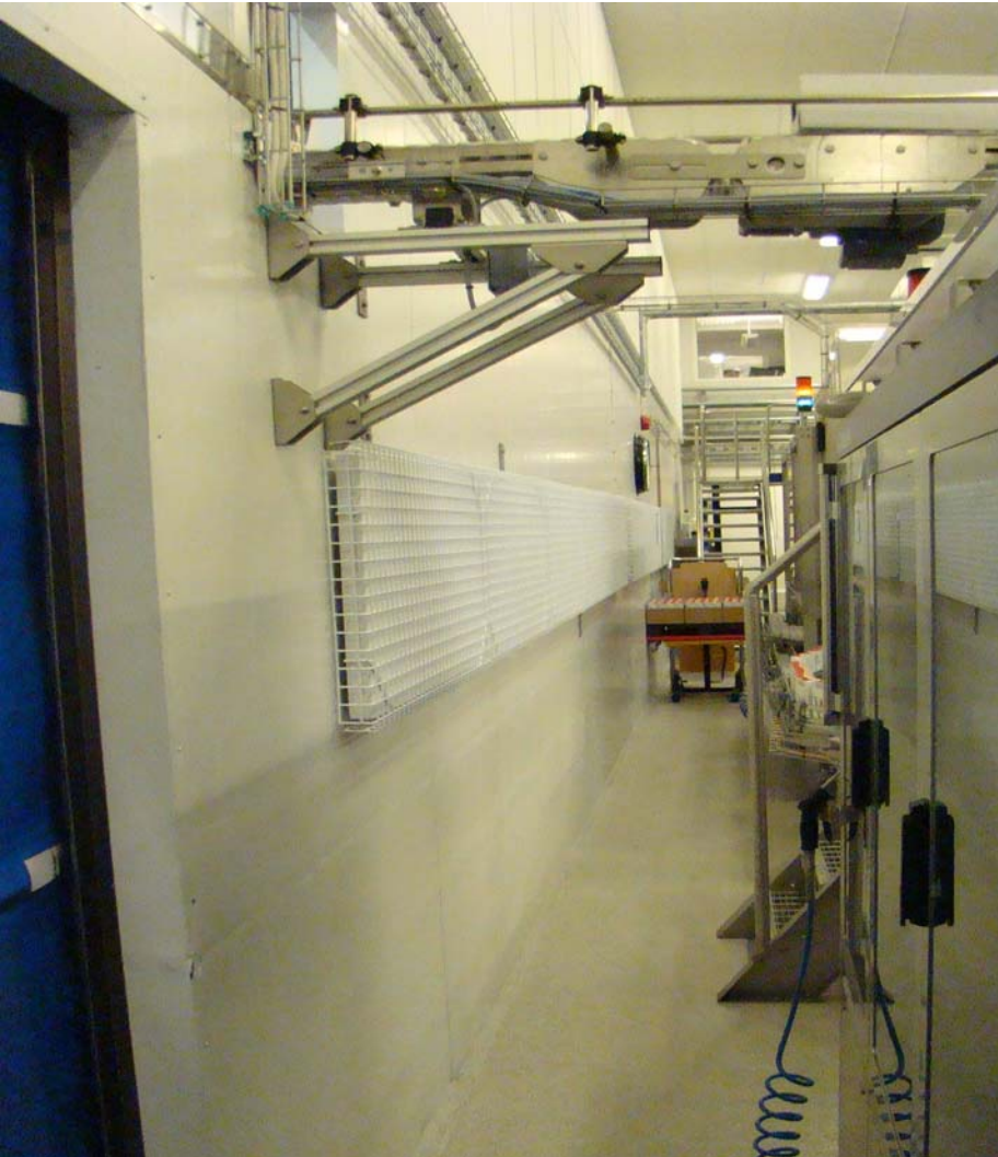
Kuva 9. Hygiene Advance Protection C3 sijoitettiin seinälle lähelle äänekkäitä laitteita..
