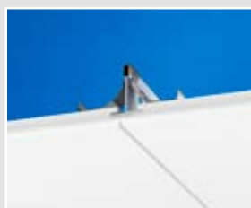
Sezione di Hygiene Labotec Ds C1 con fermo di tipo Hold down Connect Ds
